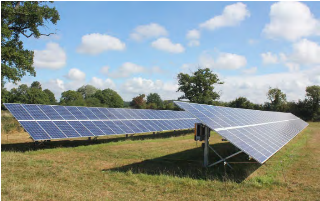
Typisk installasjon, rekke med solcellepaneler
