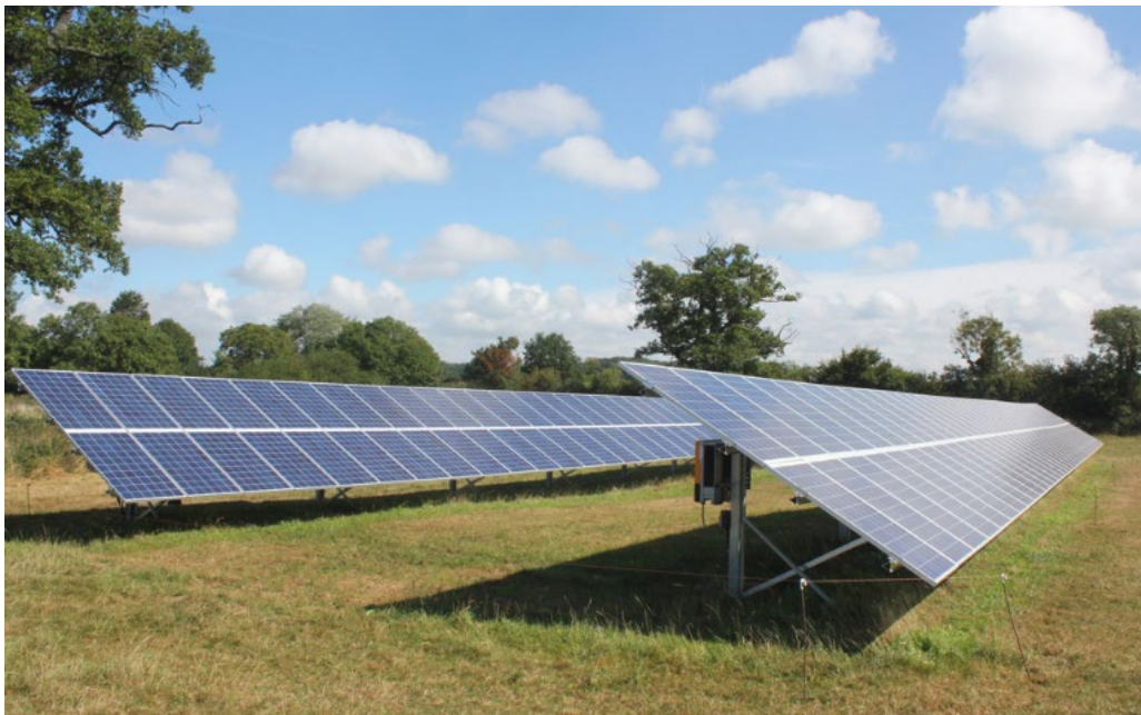
Typisk installasjon, rekke med solcellepaneler
