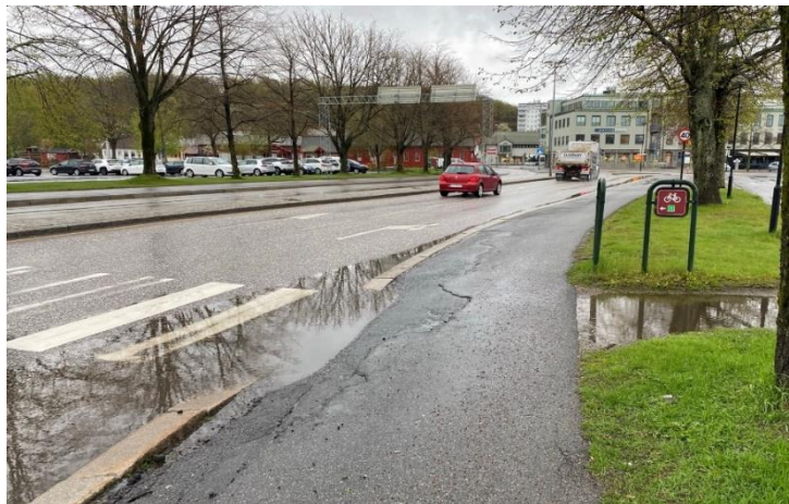
Figur 37 Tilstanden på asfaltdekket varierer på fortauet langs Strandpromenaden
